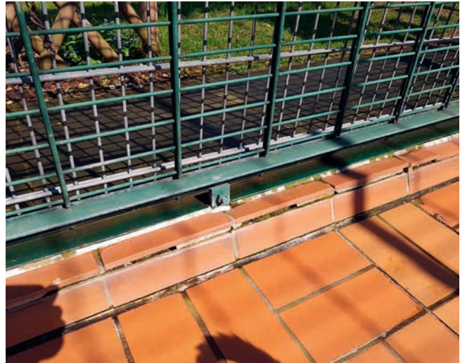
Umrandungen sind undicht
